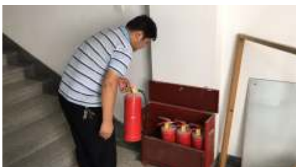
检查消防器材
